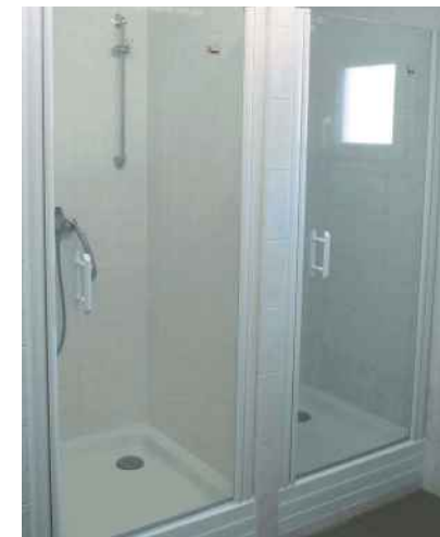
Doppeldusche mit Glastüren
